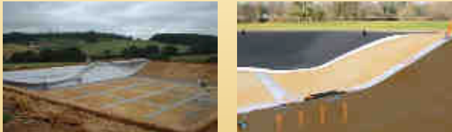
A DRAINLEMEZ-háló telepítése a talajvíz-, és gázok elvezetésére, a monitoring funkció ellátására
